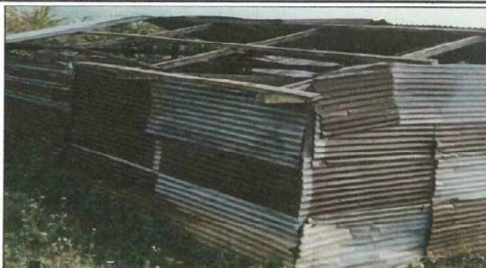
Foto 2: Techo de la cocina en malas condiciones.
