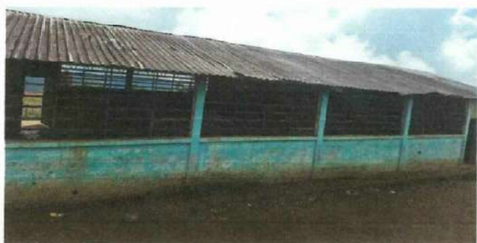
Foto 3: Aula 1, 2, Dirección y Bodega con techo deteriorado, se necesita pintar las aulas en su exterior e interior así también cambio de puerta y cambio de costanera.
