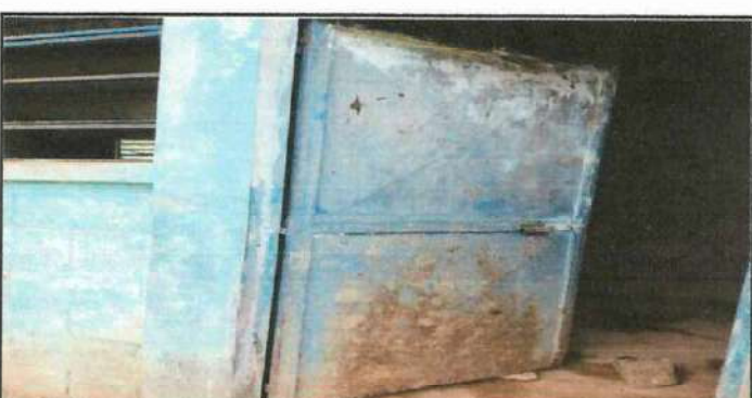
Foto 6: Puerta deteriorada de la bodega.
