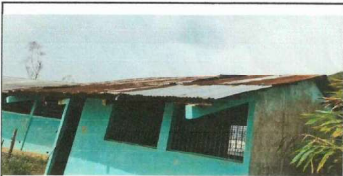
Foto 4: Aula 3 se necesita el cambio del techo ya que esta en mal estado así también cambio de puertas y el pintado respectivo.
