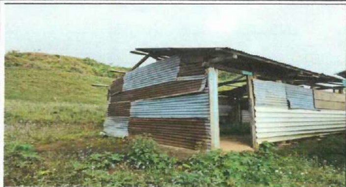
Foto1: Pared de la cocina en malas condiciones y no cuenta con puertas.
